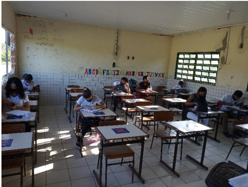
Figura 15: Sala de aula funcionando sem janela
