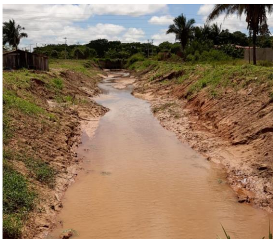
Figura 5. Ponto 3: leito do Riacho Bacuri com presença de erosão e modificação do leito
