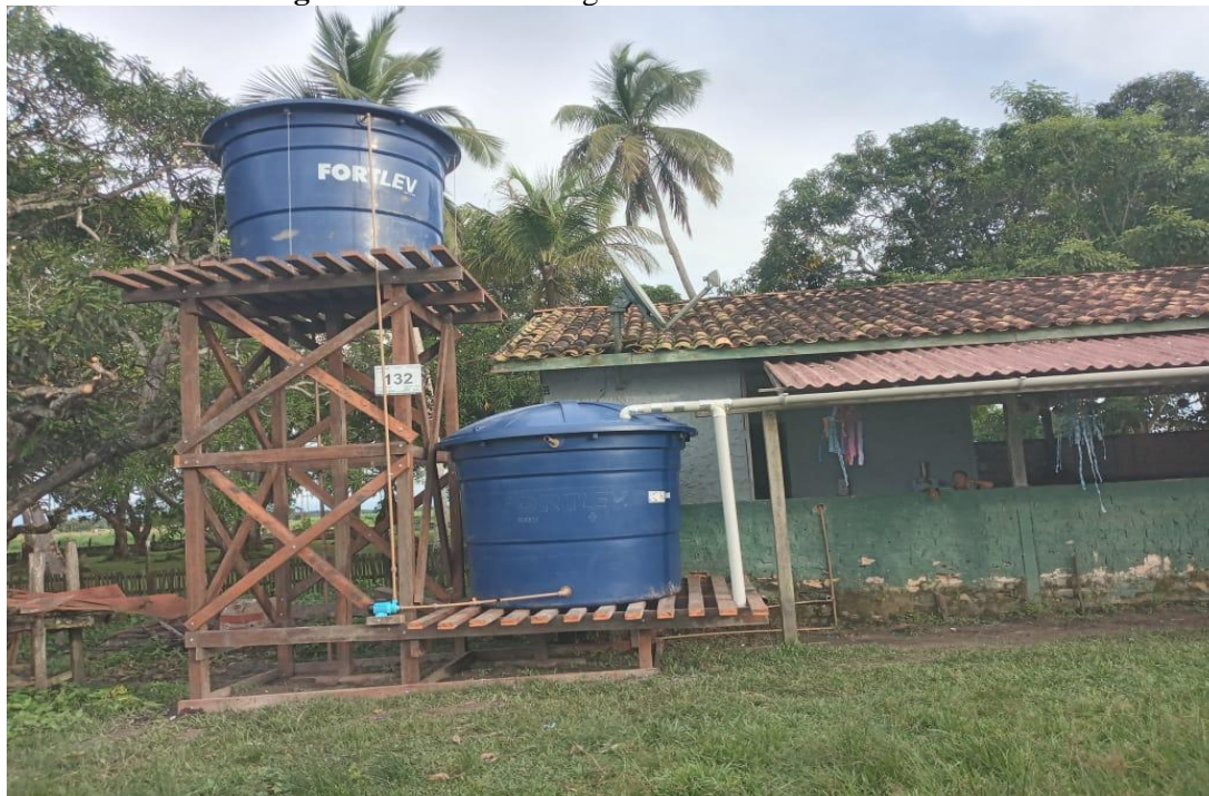
Figura 2. Cisternas de água Escola Fazenda Desterro
