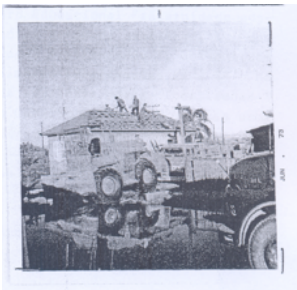
Figura 5: Trabalhadores retirando telhas de casa a ser removida, e posteriormente puxada pelo trator.
