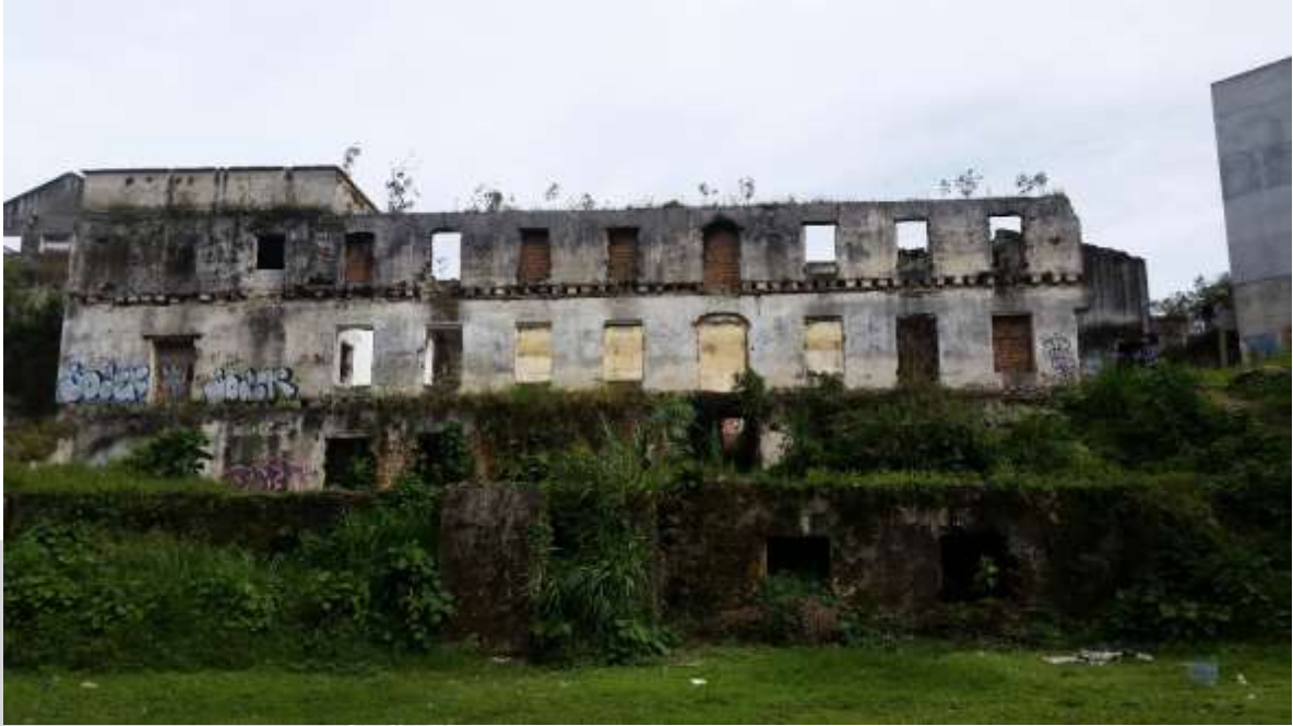
Ilustración 2. La exfábrica de San Bruno, parte del edificio del siglo XIX. Fotografía. Roca.
