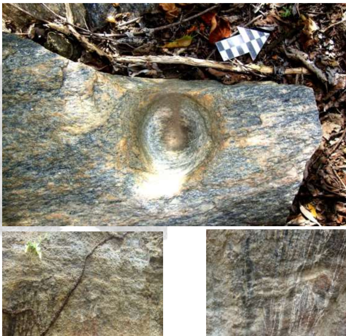
Figuras 15, 16 e 17 – Principais fatores de degradação dos painéis rupestres do abrigo. (Fonte: arquivo pessoal dos autores, 2015)
