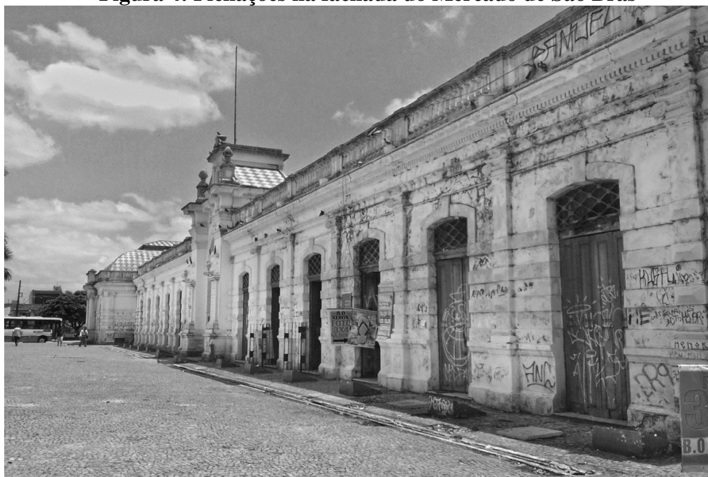
Figura 4: Pichações na fachada do Mercado de São Brás
