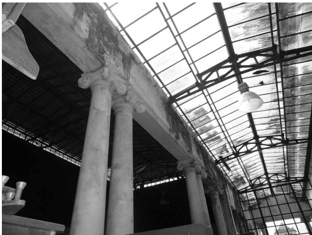
Figura 3: Parte interna deteriorada e com infiltrações
