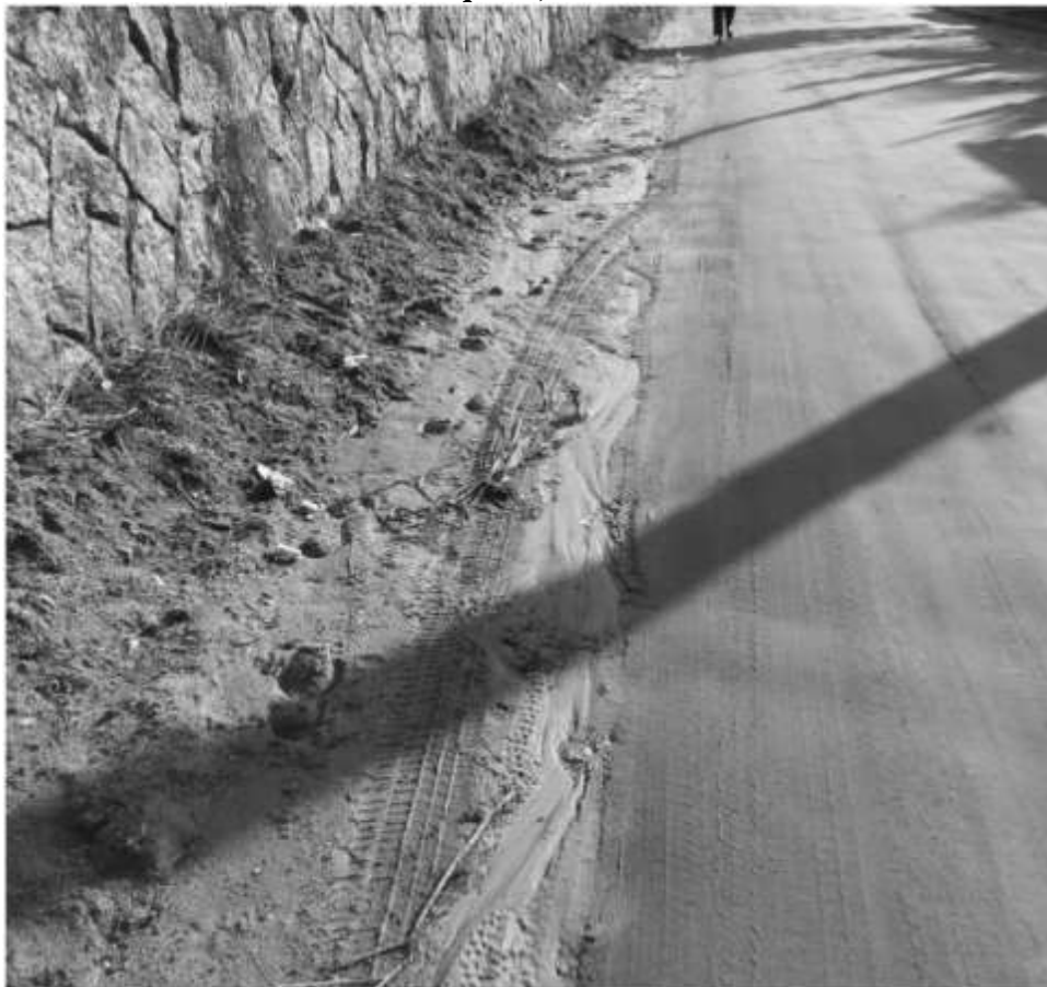
FIGURA 11 - Índice de Caminhabilidade de trecho com nota zero, sem calçada, no Rio Pequeno, Camboriú
