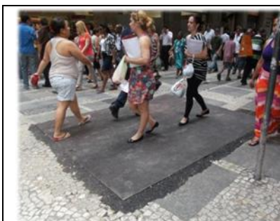
Figura 7 – Falta de manutenção no piso de mosaico português e granito da Rua São Bento. Fonte: Acervo pessoal, 2012.
